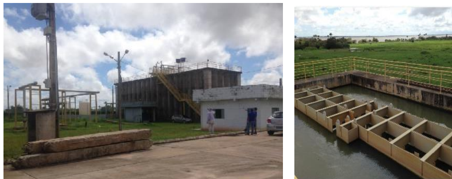
Figura 4.17 – Entrada do esgoto bruto e elevatória para peneira, depois desarenador e calha Parshall e elevatória de esgoto peneirado
