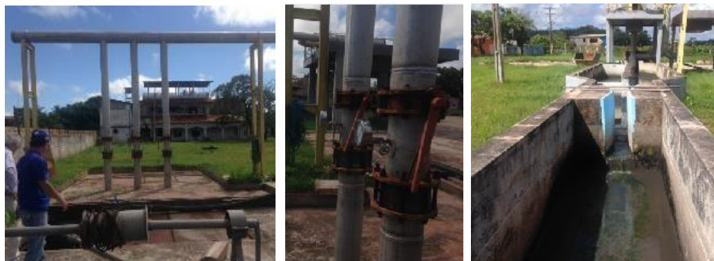
Figura 4.10 – Vista do Tratamento preliminar, elevatória para o reator, poço das bombas e conjuntos de bombas re-autoescorvantes.
