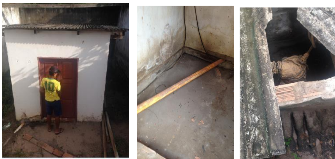
Figura 2.43 – Microssistema Maicá: Instalações do poço e recalque
