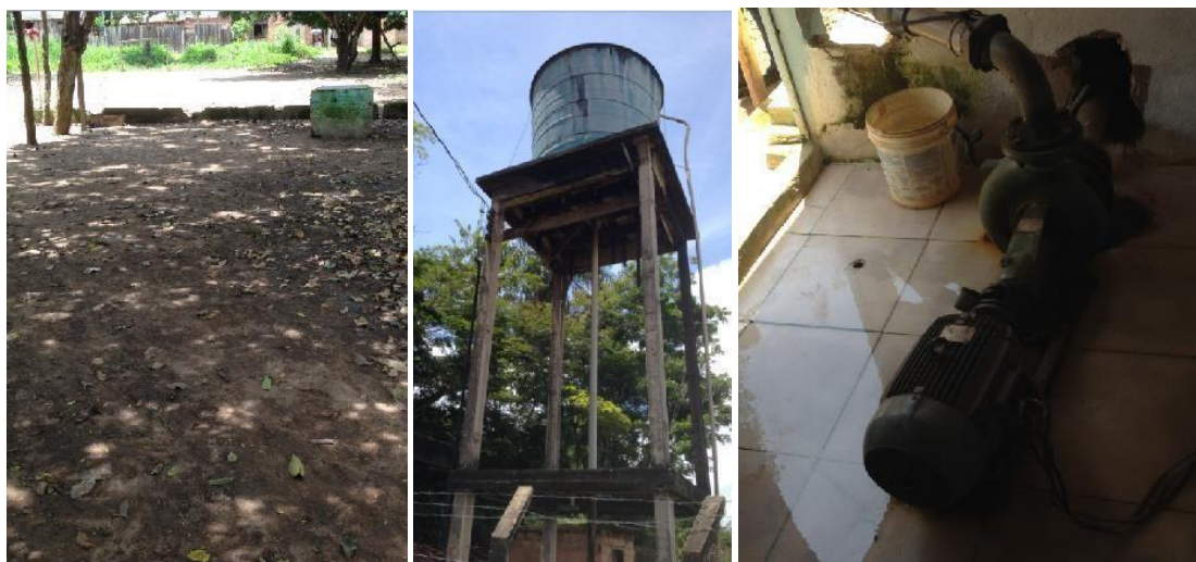
Figura 2.37 – Poço, Caixa d'água e elevatória
