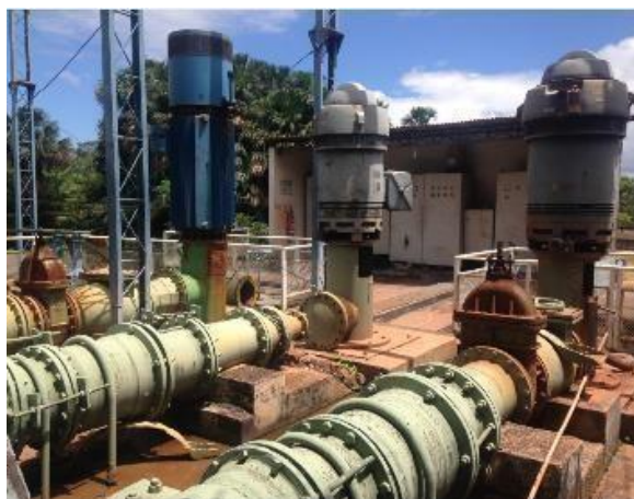
Figura 2.34 – Irurá- Elevatória para o RAP do Aeroporto Velho
